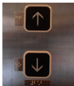
(エレベーター)
